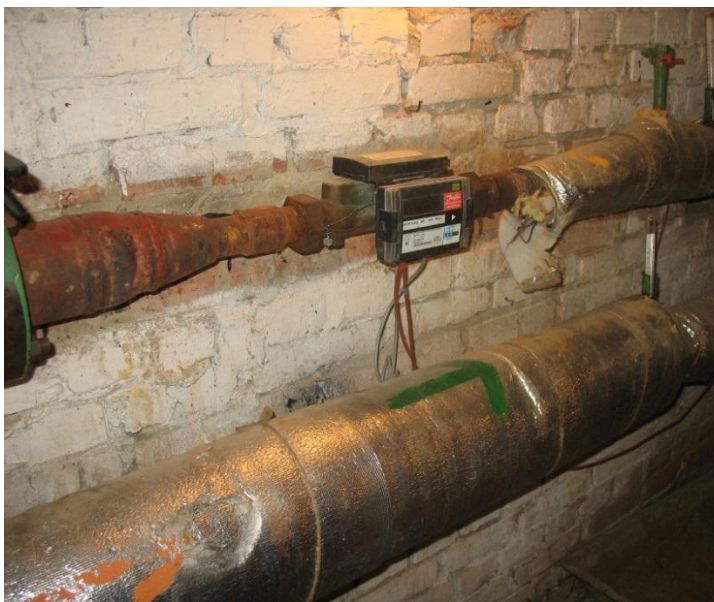
Рис. 9. Тепловий пункт будівлі
