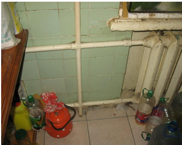
Рис. 11. Опалювальні прилади в квартирах будівлі
