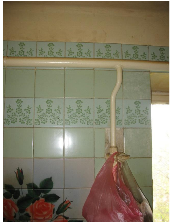
Рис. 14. Подаючі магістральні трубопроводи на останньому поверсі будівлі
