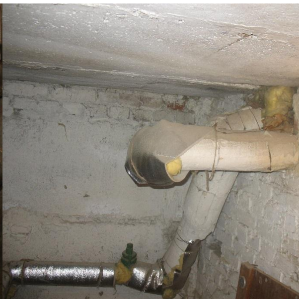
Рис. 10. Зворотній магістральний трубопровід системи опалення будівлі (в підвалі).
