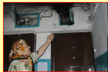
електричні розподільничі щити
