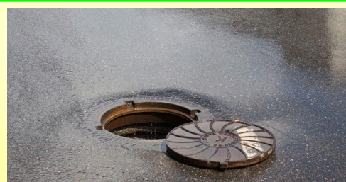
колодязі водопровідно-каналізаційного господарства
