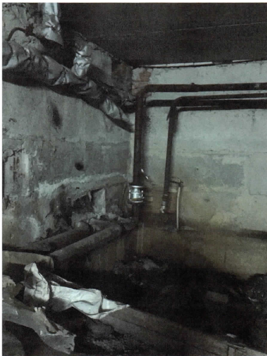
Вхідні труби централізованого опалення та гарячої води. Загальнобудинкова запірна арматура гарячої води Викопана яма в приміщенні XXV
