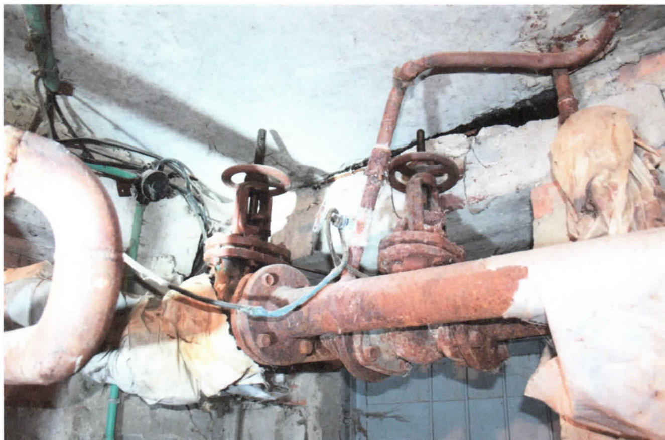
Вхідні двері до приміщення № I , труби централізованого опалення та запірні арматури
