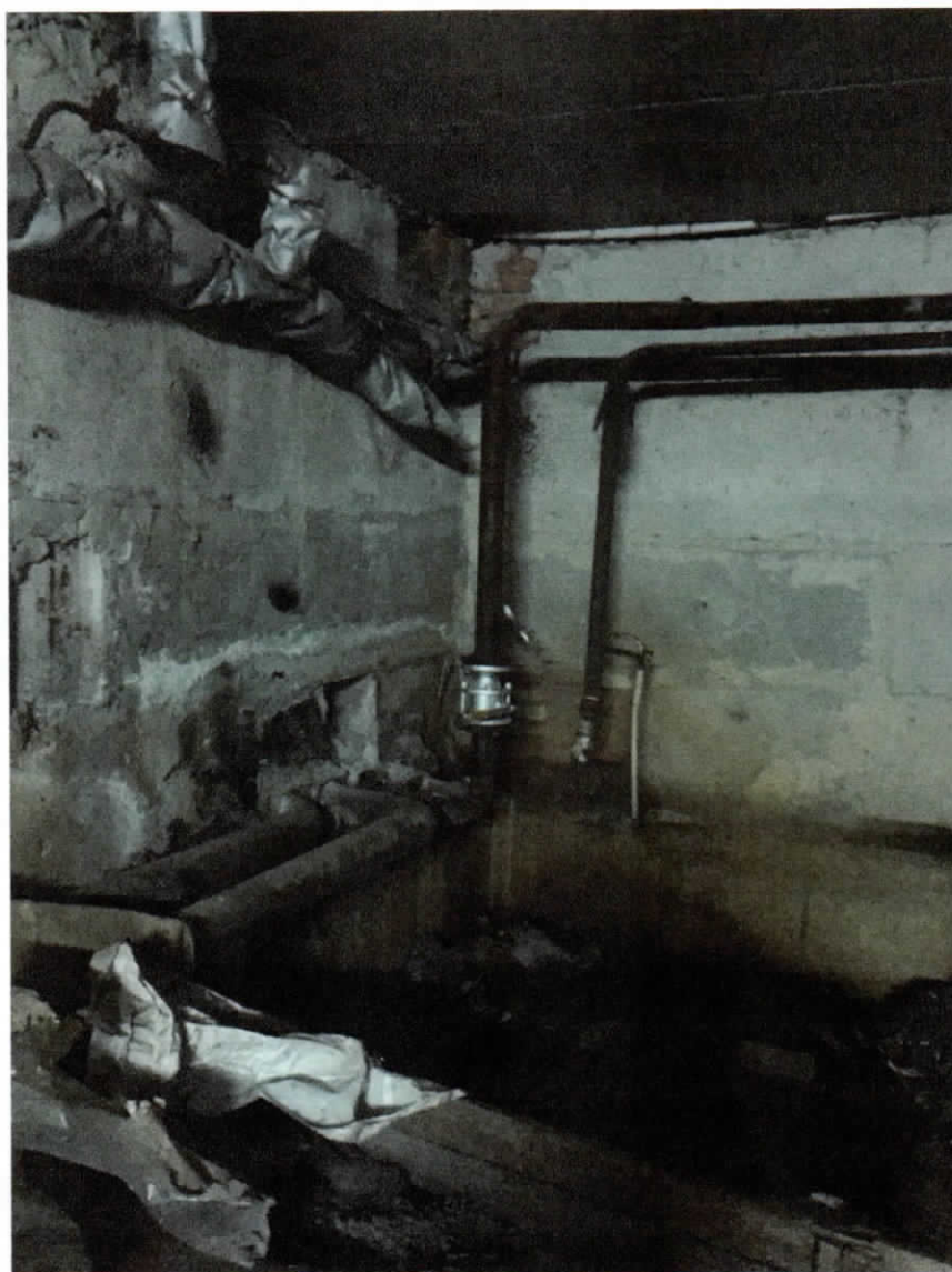
Вхідні труби централізованого опалення та гарячої води. Загальнобудинкова запірна арматура гарячої води Викопана яма в приміщенні XXV
