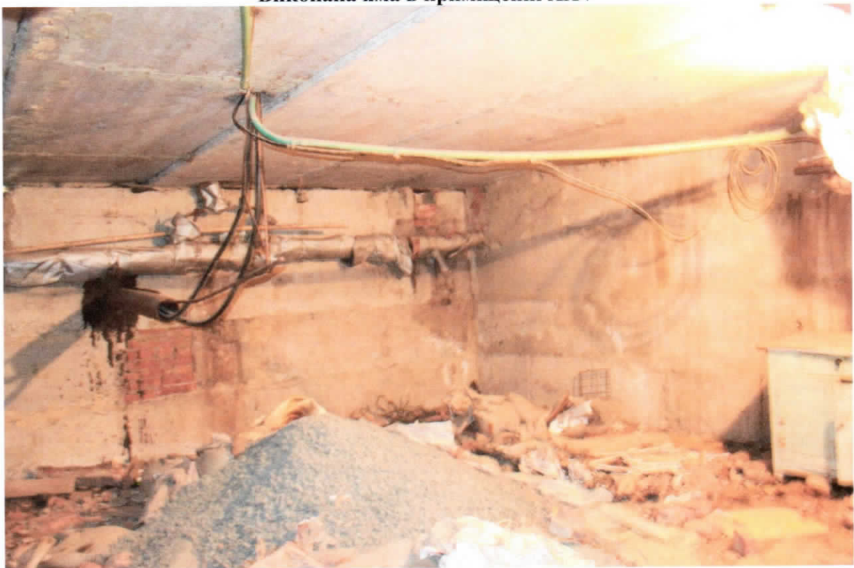
Електричні кабелі комунальної електроенергії, що заходять в приміщення № I від електричної підстанції
